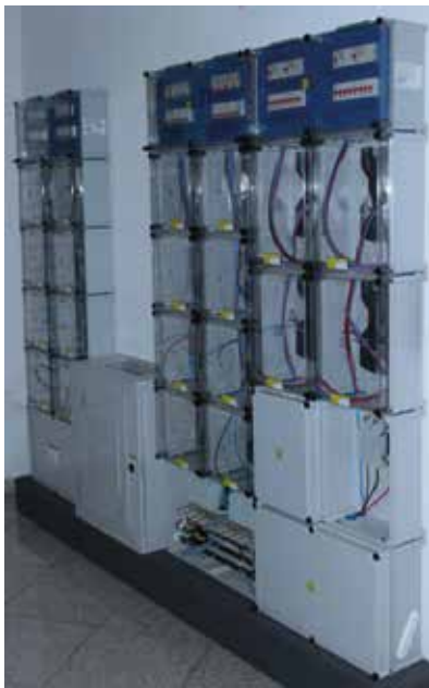
>> Ejemplo de equipamiento instalado
